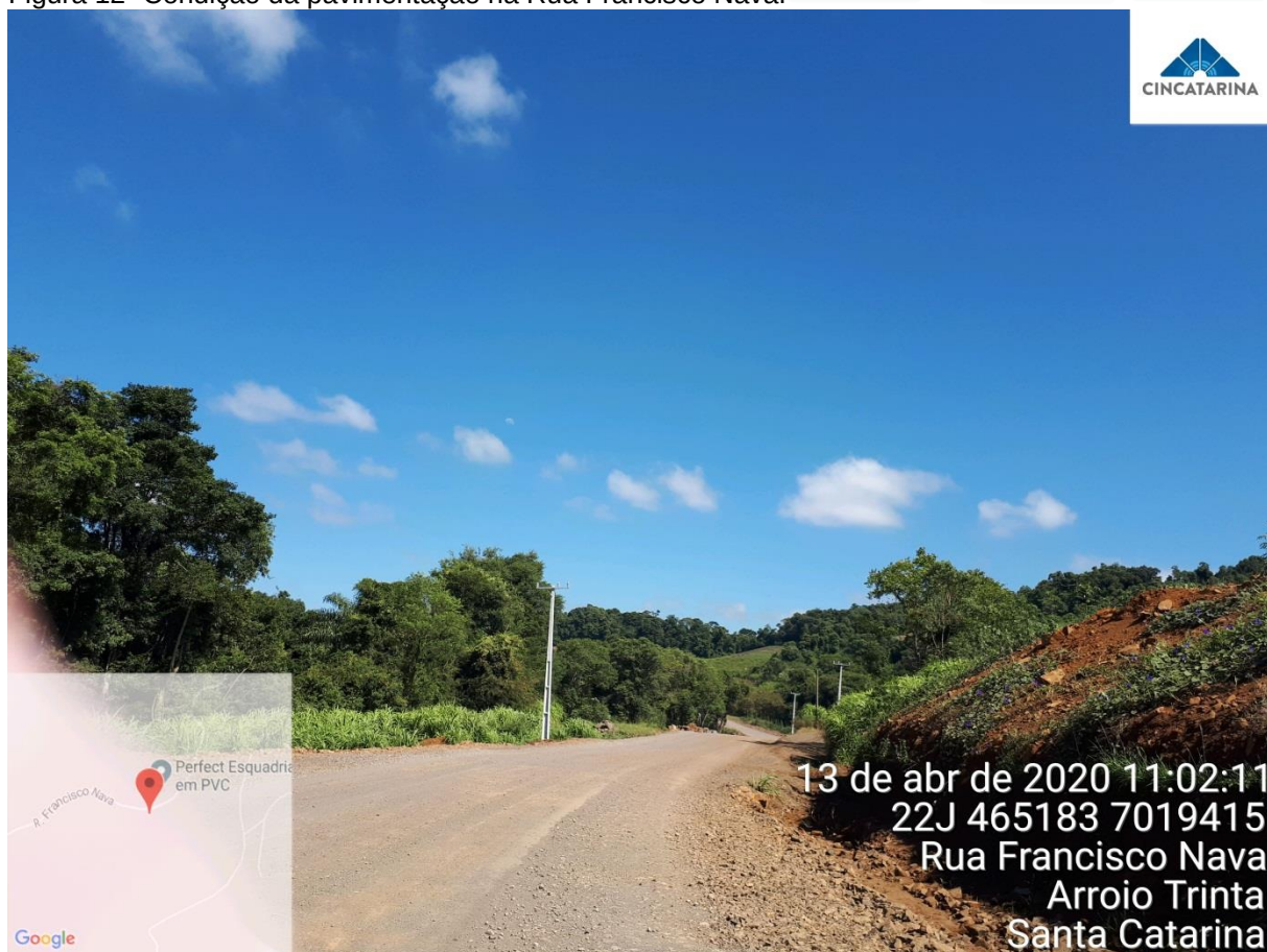
Figura 12- Condição da pavimentação na Rua Francisco Nava.
